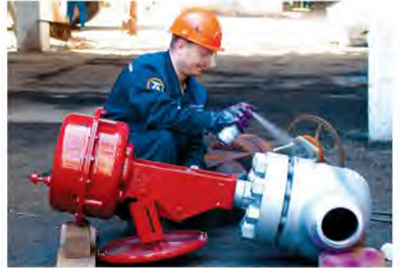
Дефектоскопист Александр Белов на агрегате аммиака №1 выполняет капиллярную дефектоскопию кромок клапана под сварку
